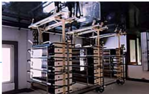
Ansicht einer Wasserentsalzungsanlage mit Plattenmodulen in Heikendorf an der Kieler Förde.
